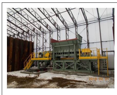
汚染土壌投入ホッパー
